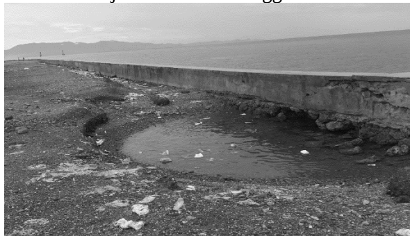
Gambar. 4. Kondisi tanggul di Desa Fatcei
