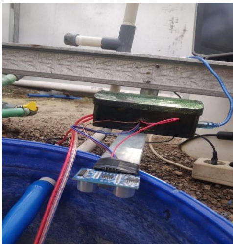
Gambar 12 implementasi perangkat keras wadah komponen tandon Greenhouse tampak depan
