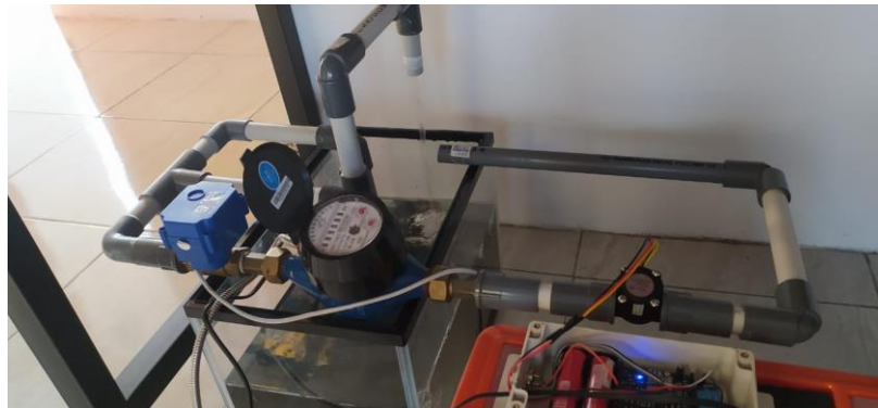
Gambar 17. Kondisi valve Ketika tertutup
